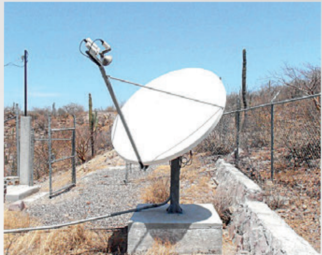
Antenne de microstation terrienne à la station auxiliaire de surveillance sismologique AS65, à La Paz, dans la région de Baja California Sur (Mexique), où une mission de maintenance a eu lieu en 2013.
