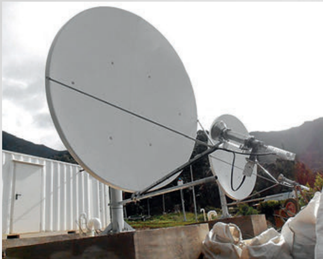
Nouveau terminal de l'ITM destiné aux stations de surveillance hydroacoustique HA3 et de surveillance des infrasons ISI4, aux îles Juan Fernández (Chili).
