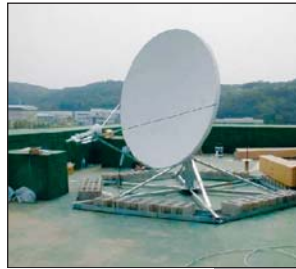
大韩民国，Daion， 国家数据中心
