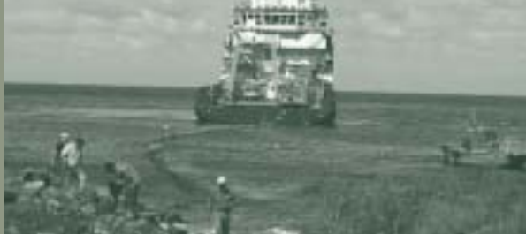
POSE DE CÂBLES POUR LA STATION HYDROACOUSTIQUE SITUÉE SUR L'ÎLE JUAN FERNÁNDEZ
