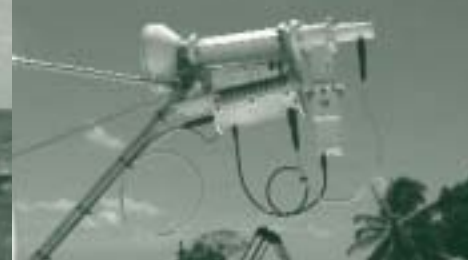
AMPLIFICADOR DE POTENCIA DE RADIO FRECUENCIA EN LA ESTACIÓN DE RADIONÚCLIDOS EN LAS ISLAS DE COCOS, AUSTRALIA
