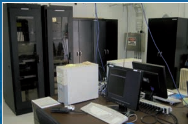
Vue intérieure du système central d'enregistrement.
