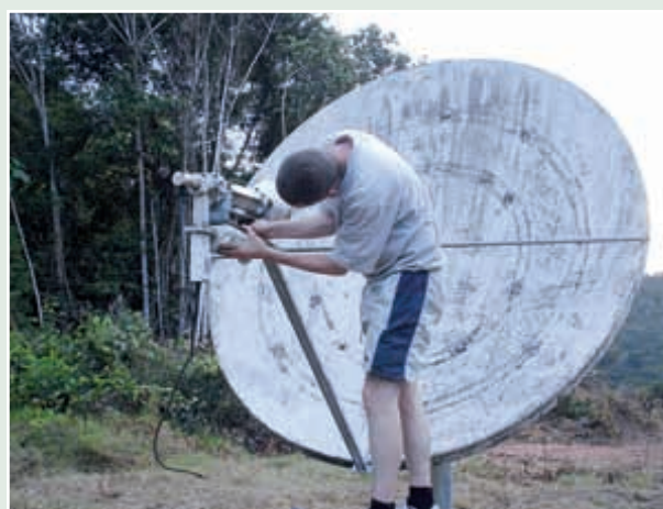
Работы по ремонту ИГС на вспомогательной сейсмической станции AS10 в Питинге, Бразилия.
