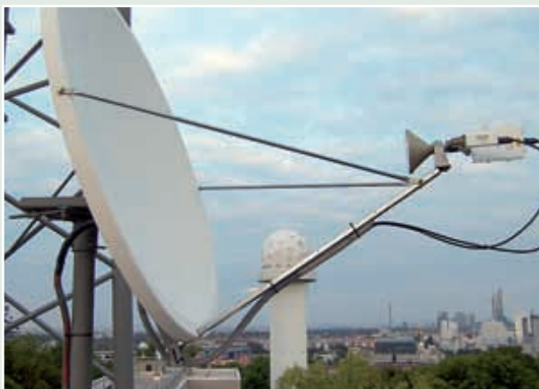
Nuevo cabezal de transmisor-receptor de radiofrecuencia instalado en la antena del Centro Nacional de Datos de Austria, en Viena.
