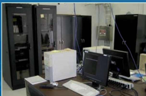
Vista del interior de una instalación central de registro.
